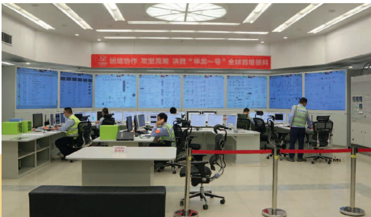
Блочный щит управления, АЭС «Фуцин» (2021 год)
