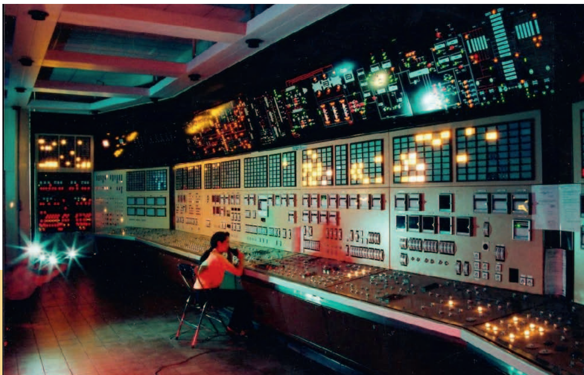
Блочный щит управления, АЭС «Дая Бэй» (1993 год)
